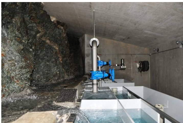
Interno Camera di Controllo e Sorgente 8
